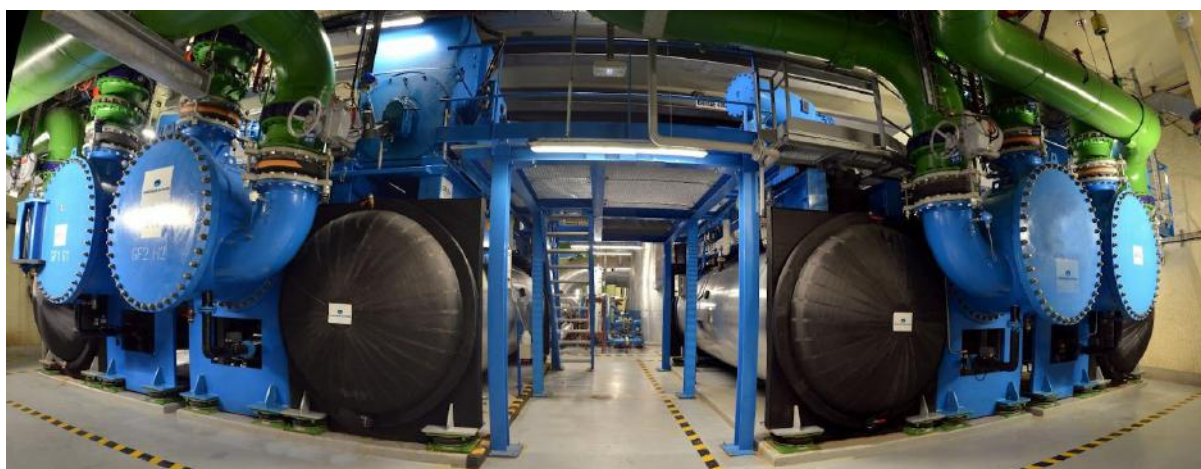
L'intérieur de la centrale "Canada" du réseau de froid de la Ville de Paris. (Crédits Fraîcheur de Paris)
