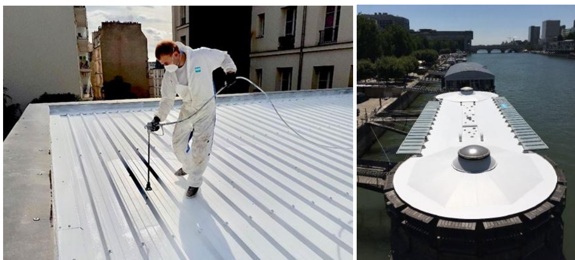
Application d'une peinture anti-chaaleur sur le gymnase Berlemont, 11 e . ; la péniche-hôpital Adamant, 13 e . (Crédits CoolRoof)
