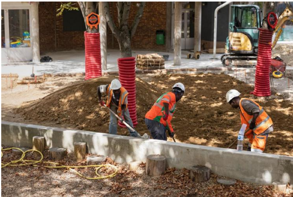
Travaux de terrassement en juillet 2022 dans la cour de l'école élémentaire Emeriau (15ème) (crédits Guillaume BONTEMPS / Ville de Paris)
